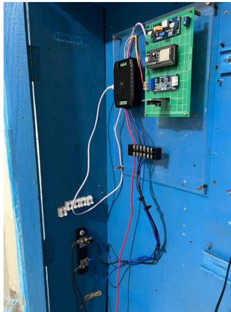
Gambar 4 node transmitter tegangan dan arus penempatan di battery station
