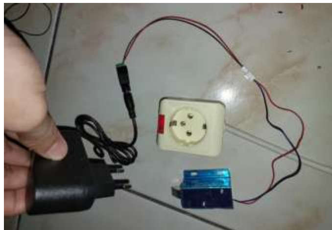
Gambar 4.7 Solenoid Door Lock tidak tersambung sumber listrik (kondisi 1) (sumber: dokumentasi pribadi)
